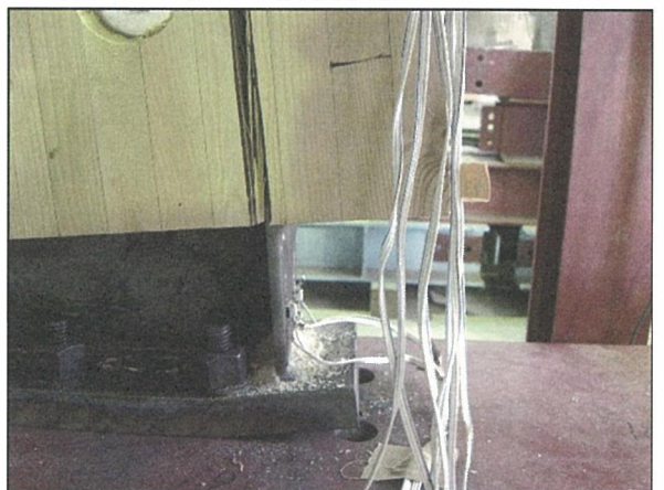
写真 5-24 試験体名 : 155-2 H鋼のベース板の曲がり 高力ボルトの伸び状況
