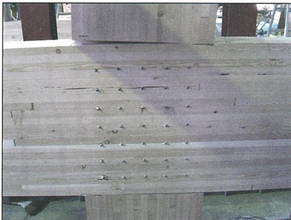
写真 5-75 試験体名：T75-2 回転による木材の圧縮めり込み 及び、引張割裂（南面）状況
