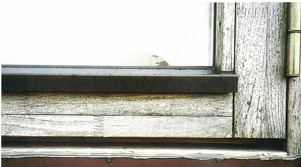
写真1 スギ集成材サッシの接着層はくり 注) カビや藻類による汚染も認められる。
