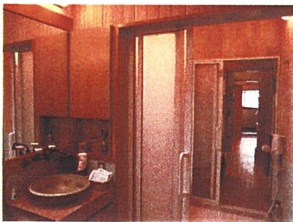
③ 壁はヒバ目透かしV目地本実加工品でプレーナー仕上げのまま無塗装で使用している。
