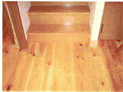
② 階段登り口を見る。床のアカマツは長手方向も本実加工されているものを使用。
