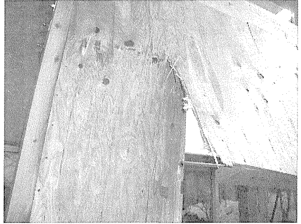
写真3—5 S type 左袖壁付近での破壊
