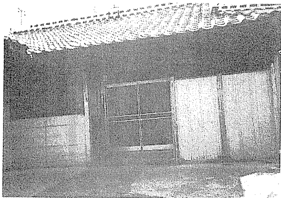
写真 13 強風を防ぐ「差し板」の例（切目地区）
