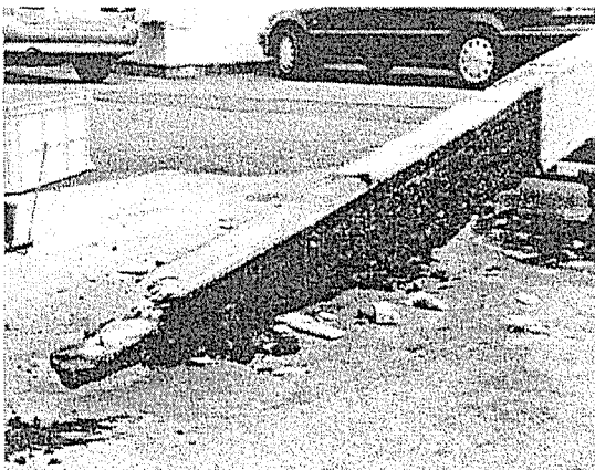
梁写真5-15 記号B-5 破壊部分状況、上面
