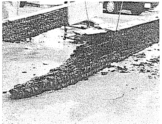
梁写真5-14 記号B-5 破壊部分
