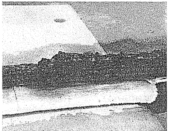
梁写真4-14 記号B-4 試験終了後、梁炭化状況
