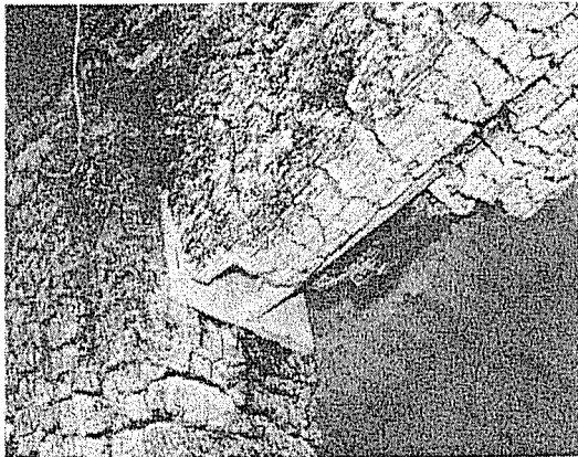
接合写真4-11 記号LJ-2 接合部の燃烧状況
