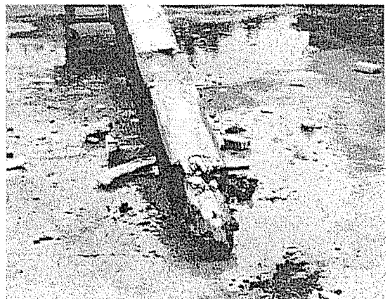
梁写真5-16 記号B-5 破壊状況、上面
