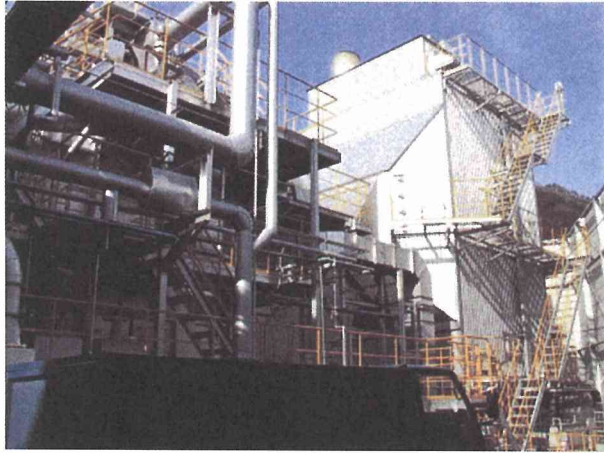
【銘建工業株式会社】 《調査写真 9.1》 木屑炊きボイラー
