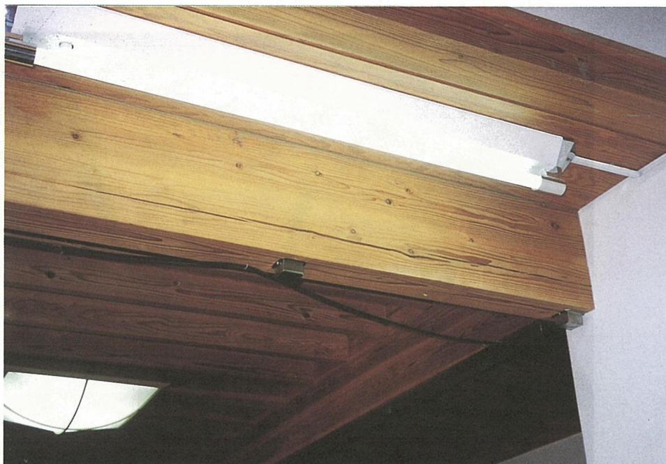
写真4 居間の重ね梁に生じた割れ 調査家屋番号： 熊-2 (熊本県)
