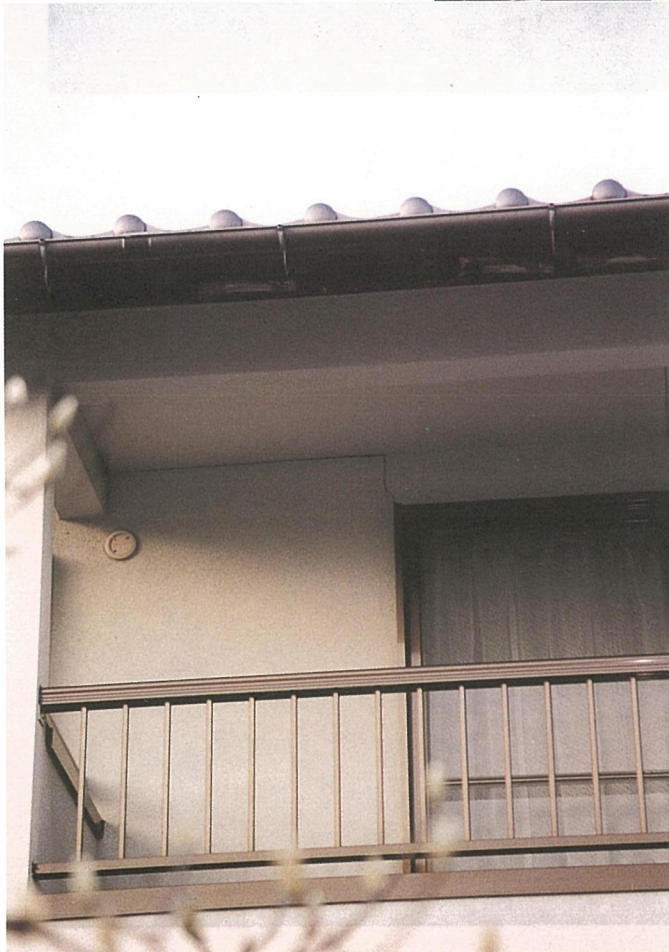
写真6 外壁に生じた亀裂
