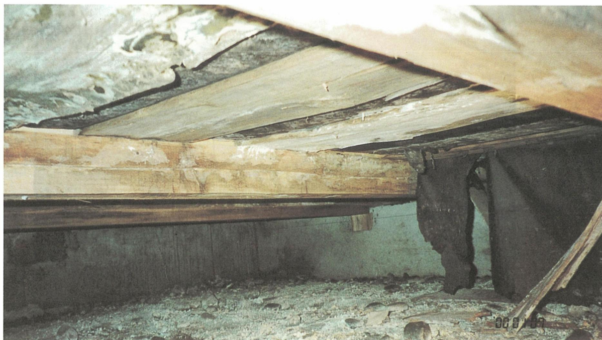
写真4 葛西邸の床下 (大引きの一部腐朽)
