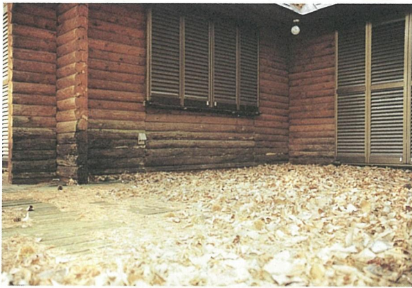
写真16 " 屋根よりの滴下水によるベランダでの腐朽
