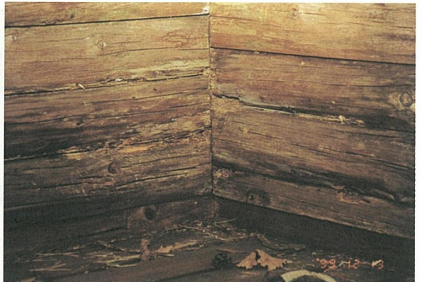
写真21 角部分での下から4段の腐朽
