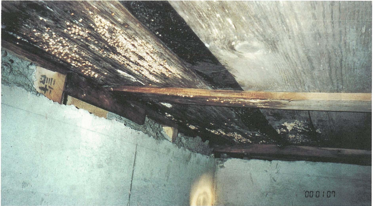
写真5 葛西邸の床下 (断熱材受け材が腐朽している)
