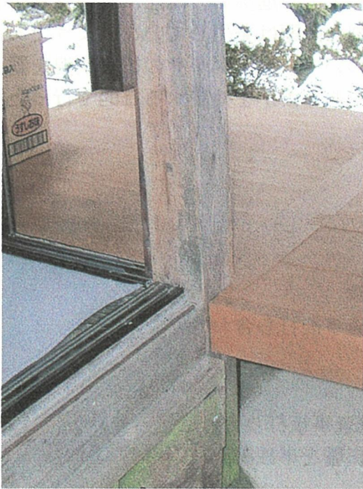
写真15 竜泉寺庫裏 東南隅の柱の根継ぎ 継ぎ手は金輪継ぎを用いている
