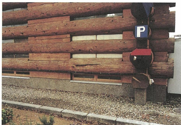
写真-13 最下段の丸太側面の腐朽
