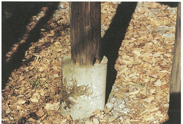
写真31 ベランダ支柱の下端部の腐朽
