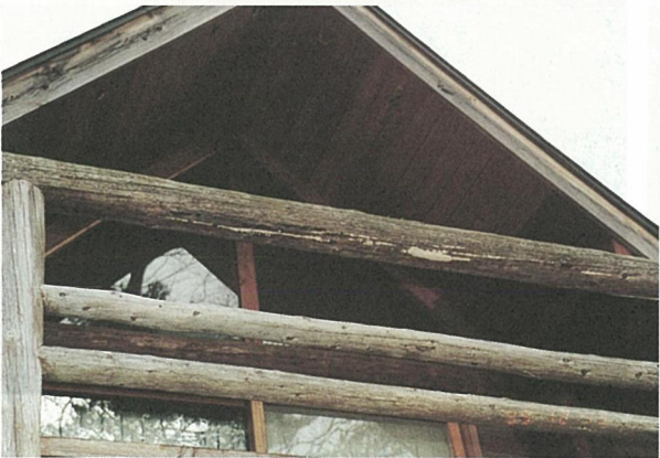
写真26 同じ建物のベランダ手摺り
