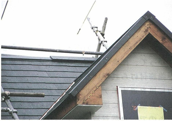
写真-1 写真中央棟が二重になっている部分
