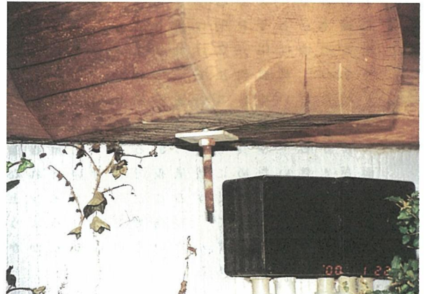
写真-7 丸太角の通しボルトの弛み
