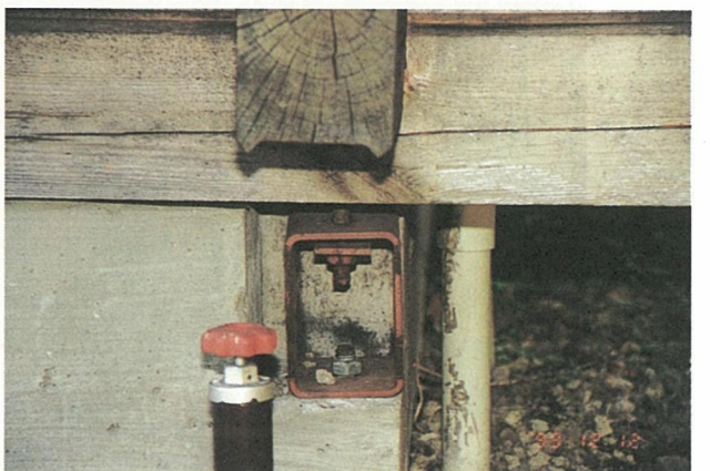
写真8 " 軸ボルトのゆるみ(築17年)
