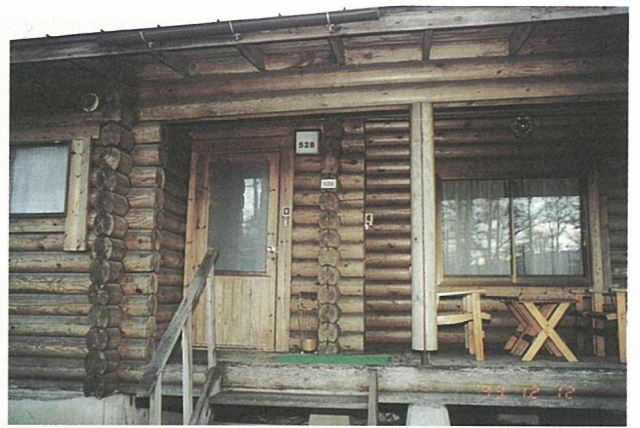
写真5 " 玄関・ベランダは庇下のたの校木損傷無し
