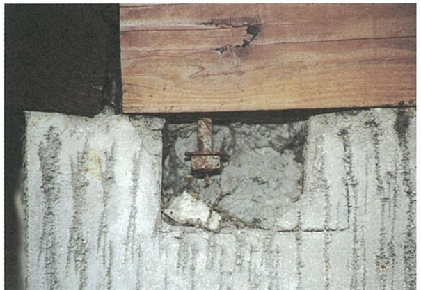
写真-10 通しボルトの弛み
