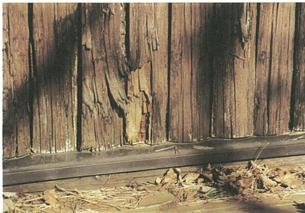
写真12 " 写真11の腐朽部の拡大
