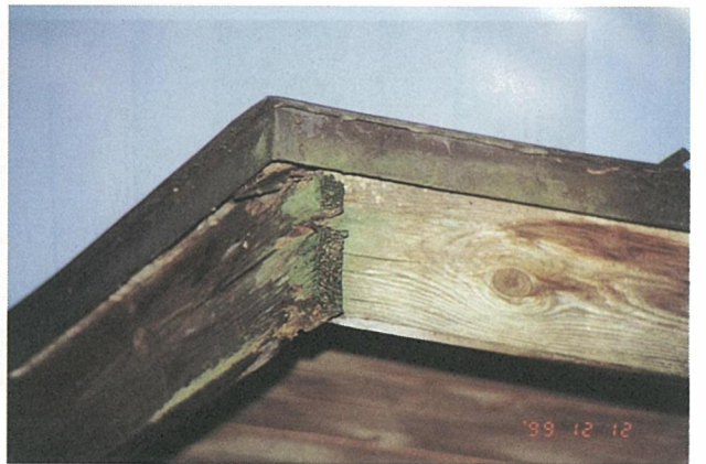
写真6 " 破風板の腐朽(築26年)
