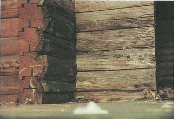
写真17 " 写真16の左角の接写 白太は両側とも腐朽
