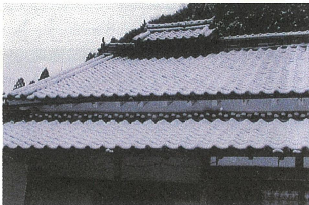
写真11 竜泉寺庫裏、屋根の外観 棟の煙出しは土間の上部に当たる
