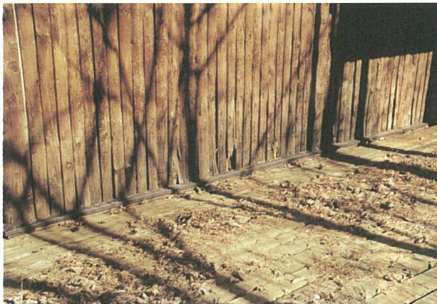
写真11 " 縦使い端部のコーキングが無い場合の腐朽
