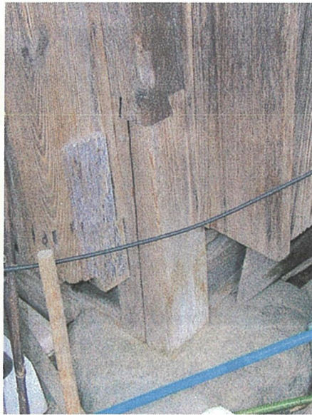
写真7 南家、東南隅柱 根継ぎをした跡が見られる
