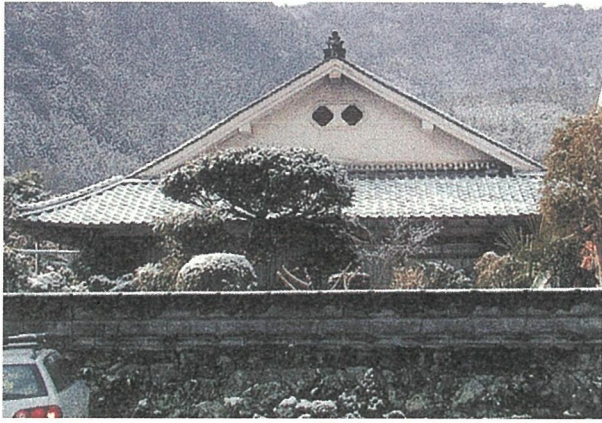
写真1 南家妻面 瓦がずれてわずかに蛇行している のが分かる
