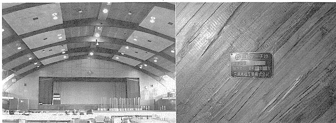
図 4-10. 新発田市産業会館の内部と湾曲集成材の接着層の剥離
