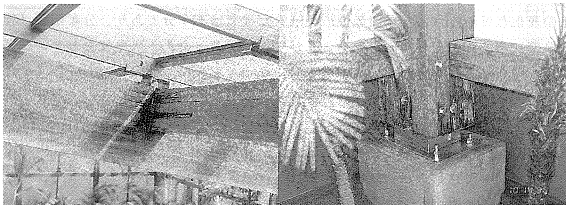
図4-15. 腐朽を生じた浴室の梁(左)と柱の脚部(右)
