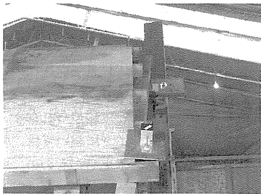
写真2-30 屋根面のせん断変形
