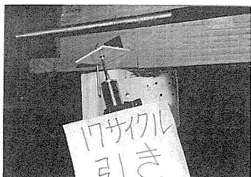
写真 2. 3. 11 17C 筋かいの浮き
