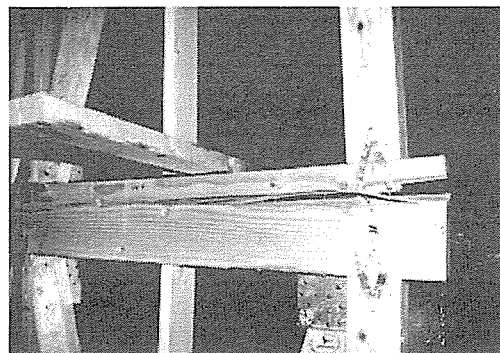
写真 2. 3. 8 16C 胴差し割裂
