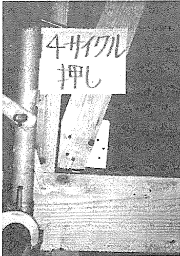
写真 2. 3. 4 14C 金物浮き上がり
