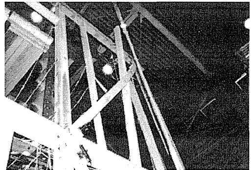
写真 3 . 35 16C 筋かい座屈による 間柱の引き抜け
