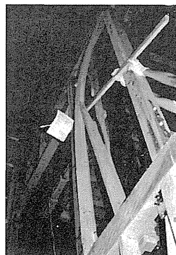
写真 2. 3. 13 17C 間柱の割裂
