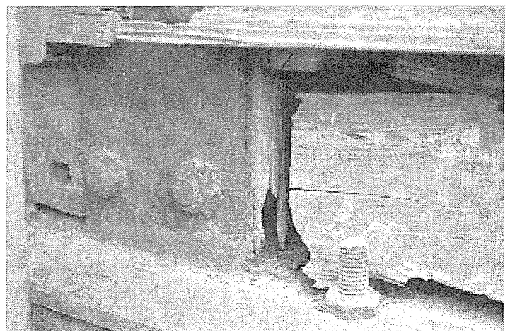
写真 2.13.4.17 アーチ脚部の蟻害箇所 (建物J)
