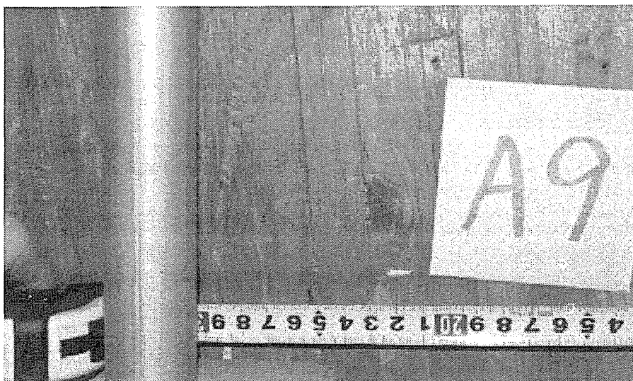
写真 2.13.4.3 集成材接着層のはく離(A9 柱) (新藤)
