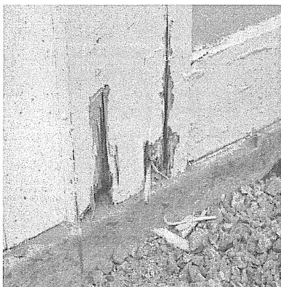
写真 2.13.4.6 建物D北側柱集成材の蟻害
