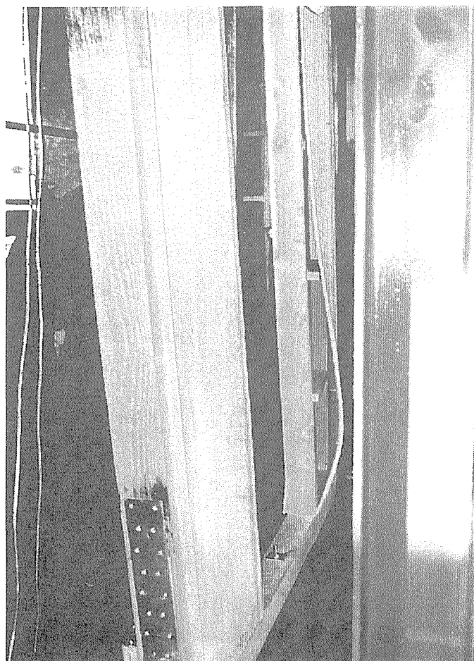
写真 6-28 門型真壁補強 (-1/15rad 時、面材の破壊状況)
