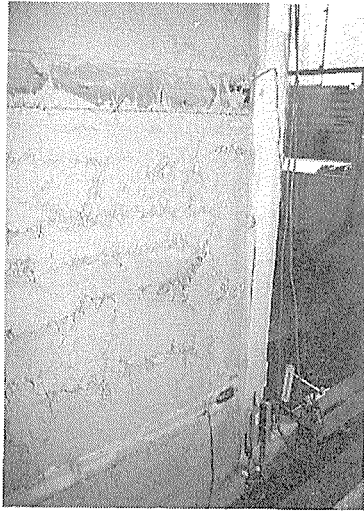
写真 11 洞貫・地貫間の壁土せん断 ひび割れ(No.3b)
