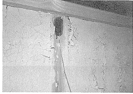
写真 12 立貫と桁の隅角部圧壊 縦方向の下地竹に沿ってひび割れ(No.3b)
