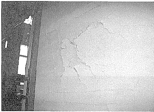
写真 13 内法貫・洞貫間のせん断ひび割れ
