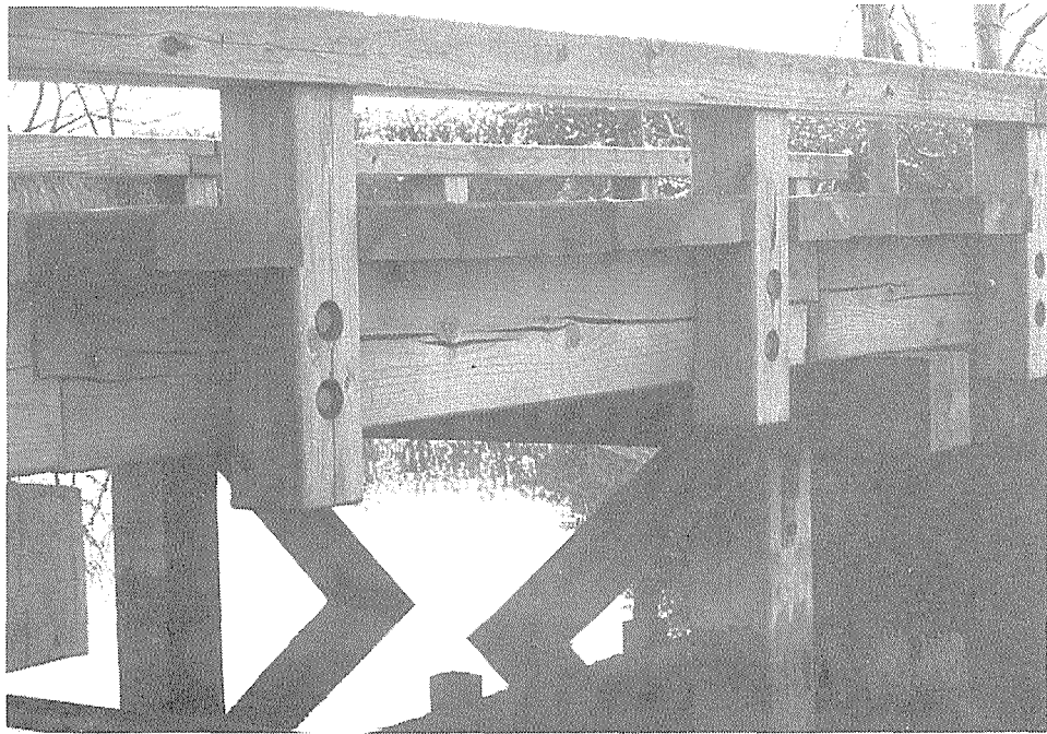
写真8 手賀沼親水公園桁橋 桁-高欄柱接合部周りの割れ
