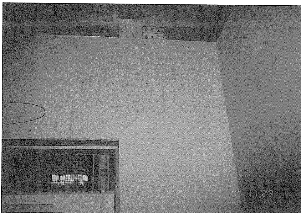
写真 B - 6 フェーズ 2、N0.7 終了後 石膏ボードの亀裂
