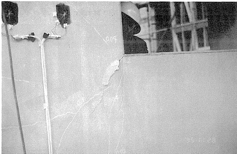
写真B-2 フェーズ1、NO.3終了後 モルタルの割れ
