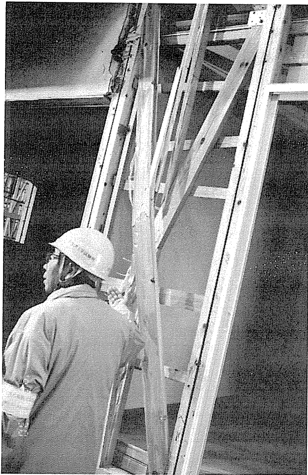
写真B-12 フェーズ4、NO.10終了後 筋かいの座屈
