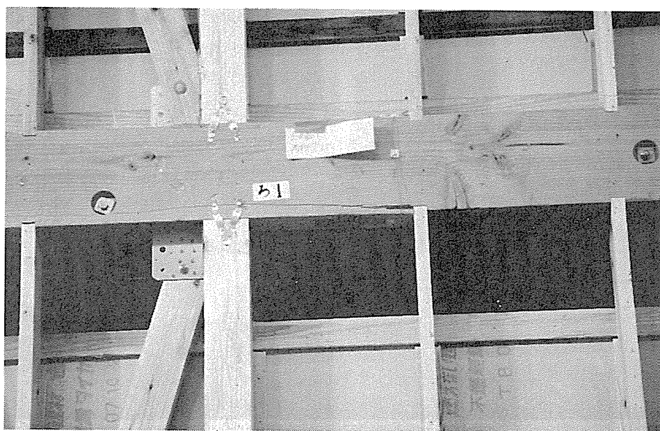
写真 A - 7 フェーズ 2、N0.6 終了後 胴差の割れ
