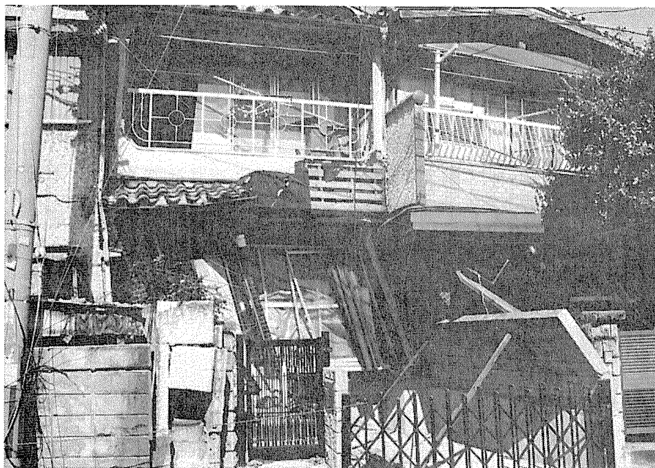
写真1 阪神・淡路大震災の 被害例 1階部分が完全に崩 壊している。
