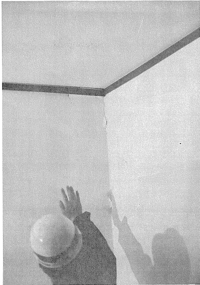
写真B-3 フェーズ1、NO.3終了後 内装クロスの割れ
