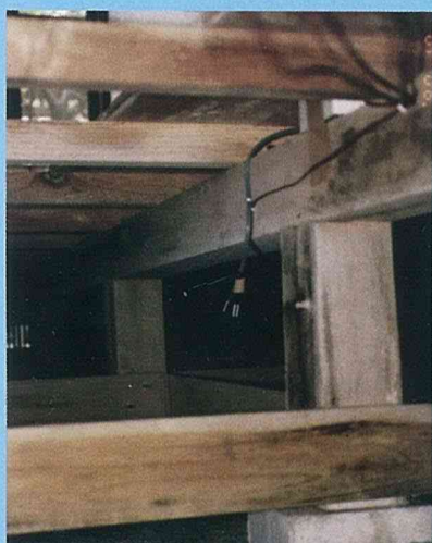
木炭を敷設する前の床下。結露でかびが発生しています。
