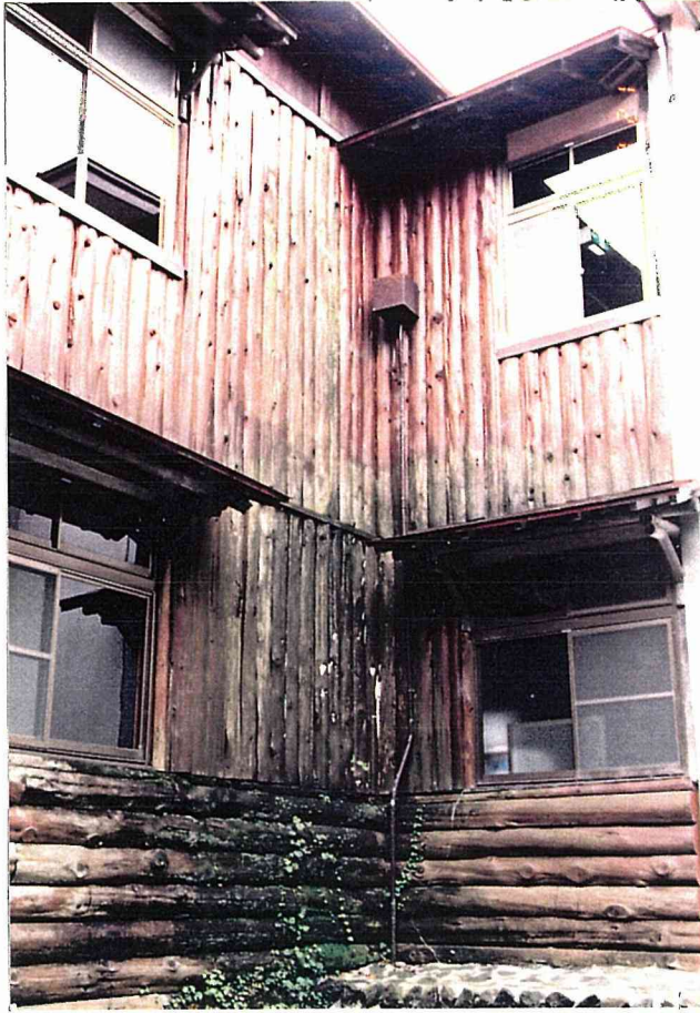
写真 2-4 外壁脚部の腐朽
