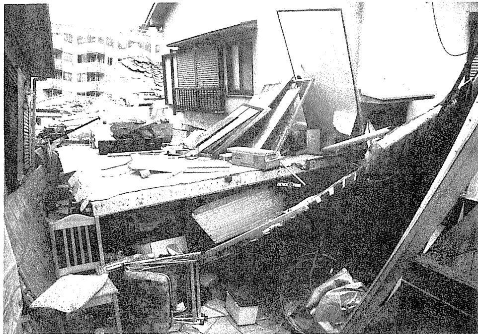
〔写真 21〕 1階が倒壊した建 物。 （神戸市東灘区）
