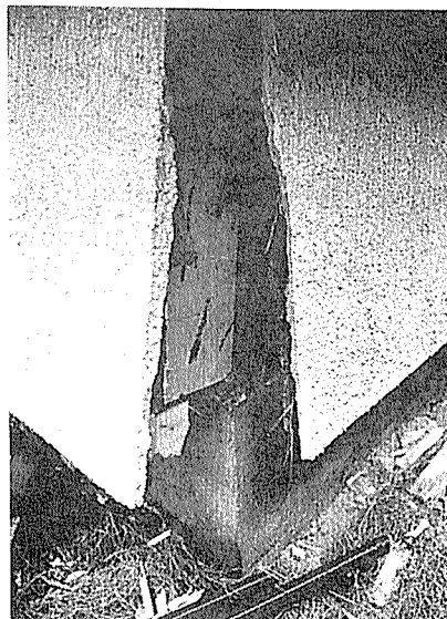
1階居間南西隅通し柱 土台から通し柱が踏み外している。この上部では柱が折損している。
