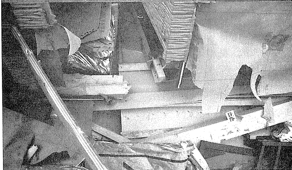
〔写真 5〕 同上住宅詳細。外 壁はコンクリート 系のサイディング を間柱に架けてい る。下地合板がな い。また、筋かい には金物が使われ ている。
