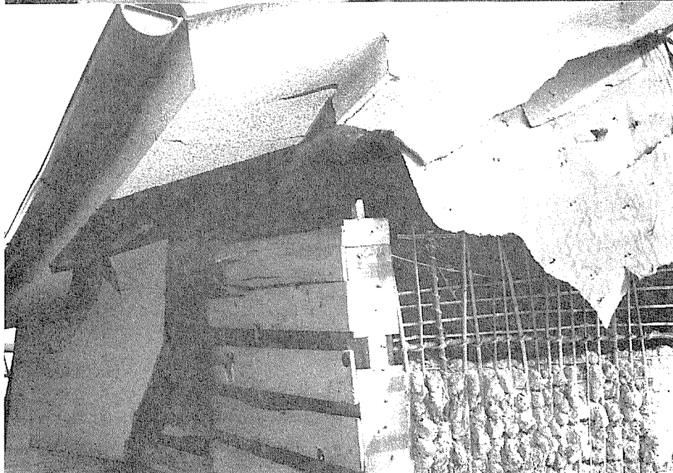
〔写真 32〕 同上住宅詳細。柱 上部で短ほぞで桁 に刺さっているの みで、金物がない。
