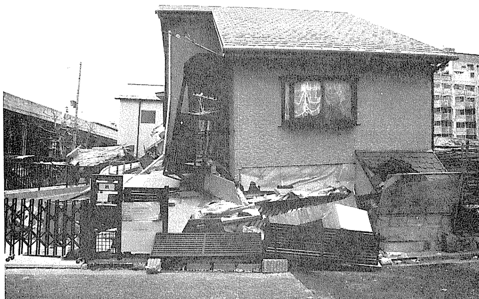
〔写真 4〕 同上住宅。屋根は スレートで比較的 軽くできている。 1階に18畳の居 間があったという。
