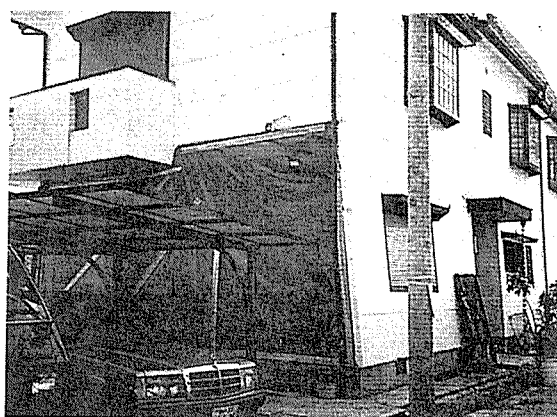
建物東面 外壁仕上げ材が剥落し、仮補強され、シートで覆っている。
