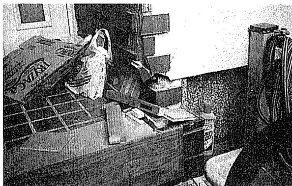
1階玄関廻り外壁材 玄関廻りのモルタル亀裂。玄関の煉瓦も剥落する。
