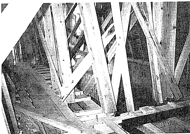
建物1階内部 筋かい、柱全て土台から踏み外している。
