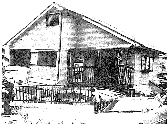
建物全景南面 完全に1階が倒壊してしまい2階のみ残る。
