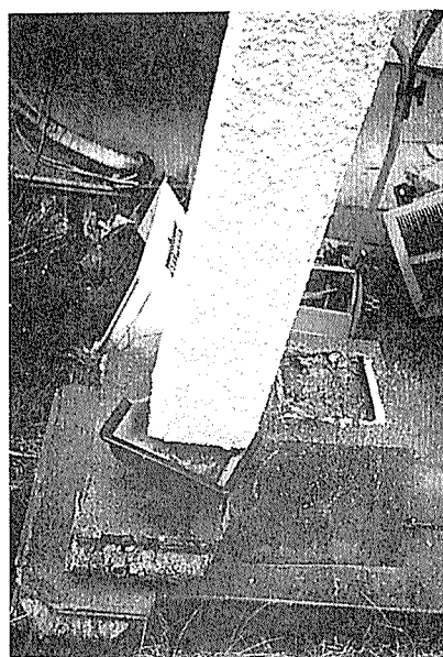
ベランダ支持柱脚部 2階ベランダ支持柱、柱脚部で踏み外し。
