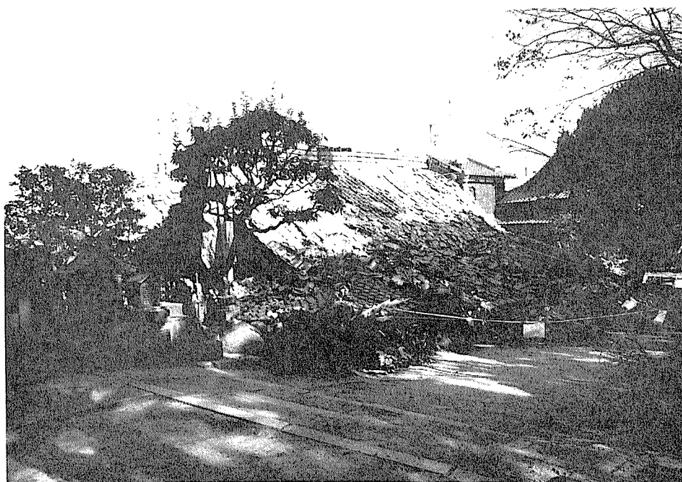
〔写真 34〕 同様に、軸組が倒 壊して屋根のみと なった寺院。 （神戸市須磨区）
