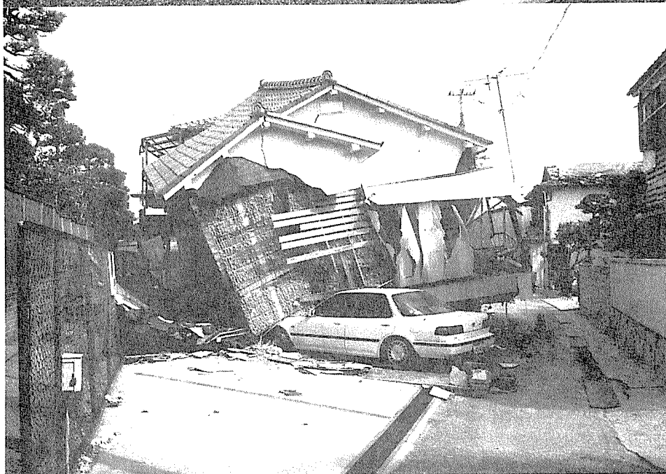
〔写真 31〕 1階が崩壊した住 宅。土塗り壁の貫 は2段しか入って いない。 (神戸市須磨区)
