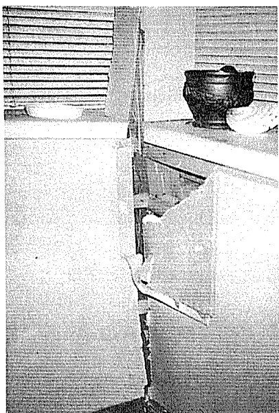
1階居間南西隅通し柱 1階南面柱踏み外し写真の上部（内部から撮影）。
