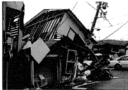
1階車庫建物の横転 1階に車庫を設けた建物は実質的には、混構造3階建てです。2階部分で大きく傾いたものが数多く見られました。
