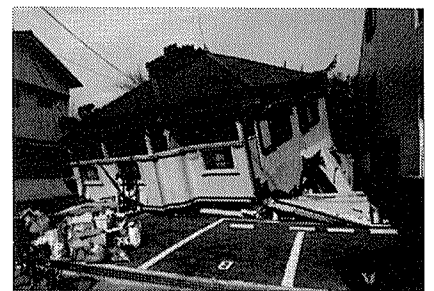
比較的新しい建物の倒壊 壁量の少ないもの、および配置の悪いものでは、新しい建物でも倒壊したのが見られました。
