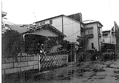
屋根が陥没した建物 屋根が窪むように壊れているものも見られました。屋根の一体性が乏しかったか、あるいは軸組の接合部が破壊したものと考えられます。
