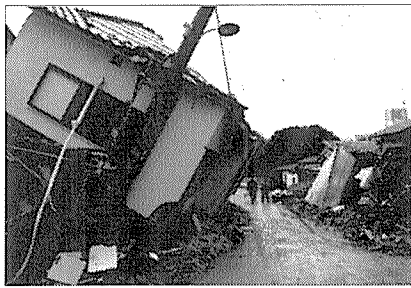
建物の横転 壁配置の釣り合いの悪い建物では、弱い部分から倒壊が生じます。
