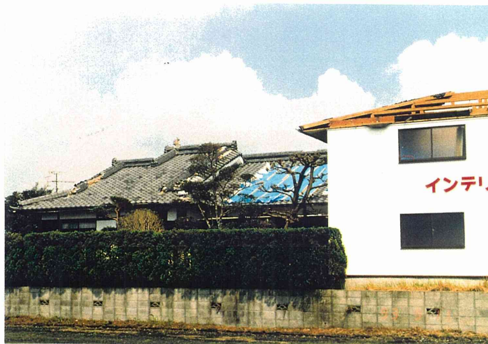
最も多かった屋根部分の飛散被害
