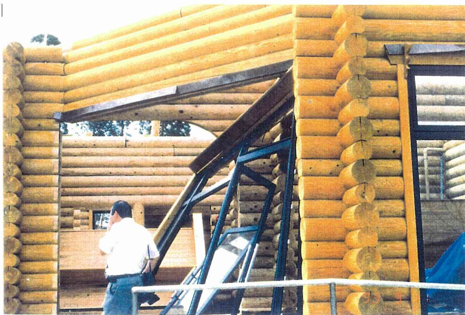
吹き倒された出入口 口枠（上部がセト リングのため止め られないので幅の 広い開口部は避け た。） 南側
