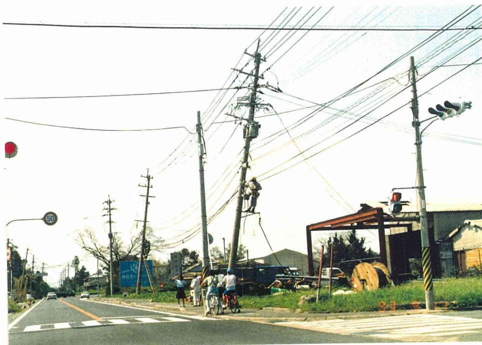
高圧鉄塔、コンクリート電柱等も被害を受けた
