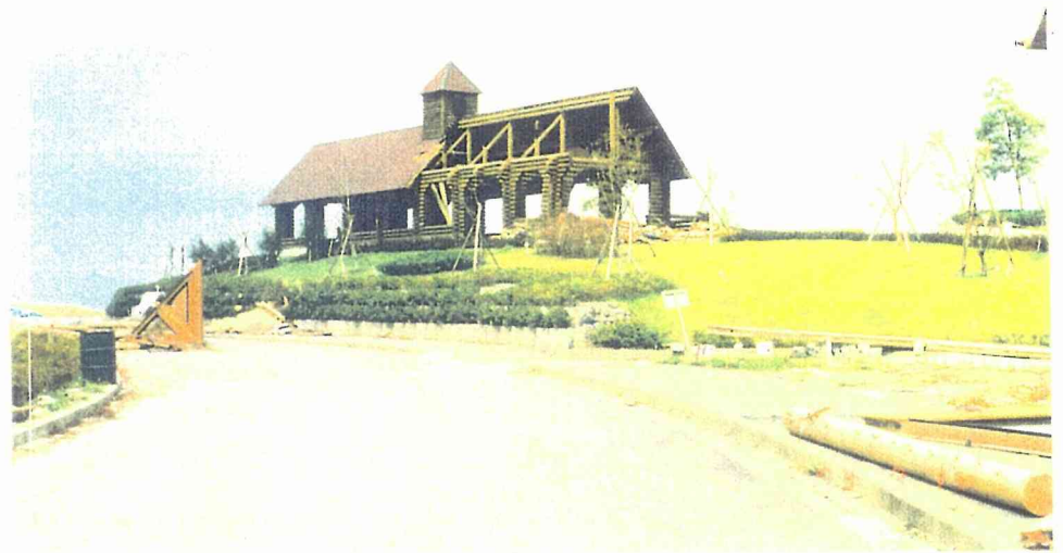
小屋組飛ばされた 建物より70m 上部 建物屋根半分飛散
