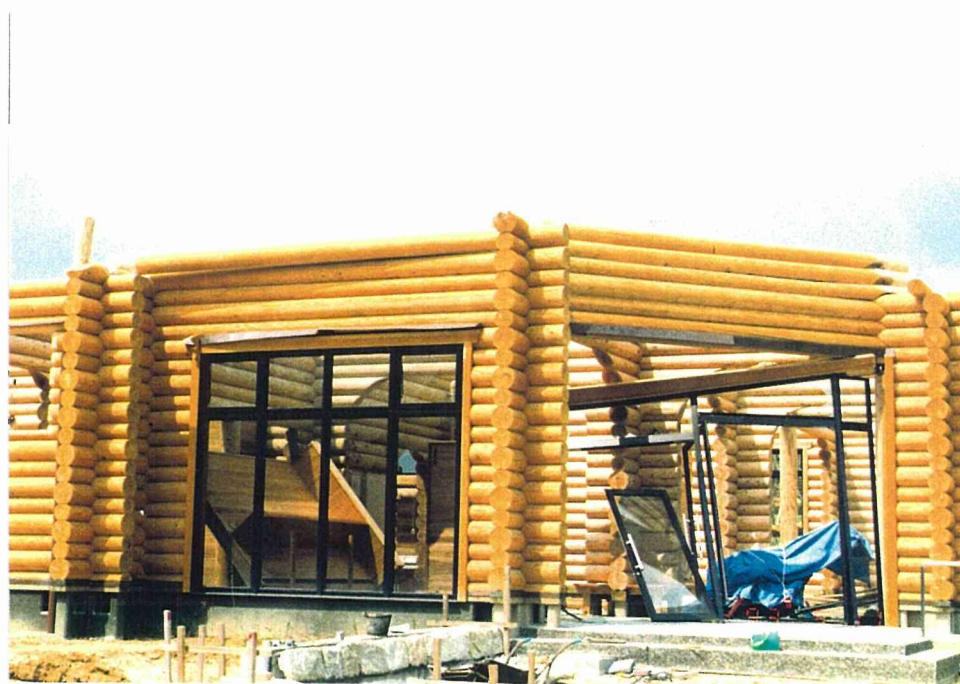
強風で吹き倒された出入り口サッシ（ログと斜めに取付）
