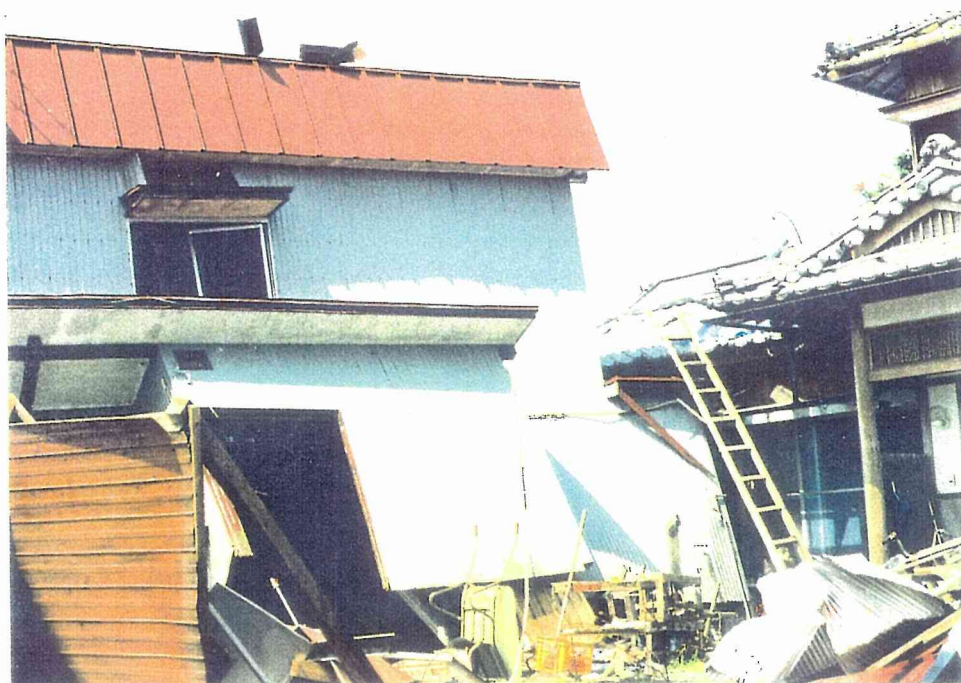
古い家屋の倒壊
