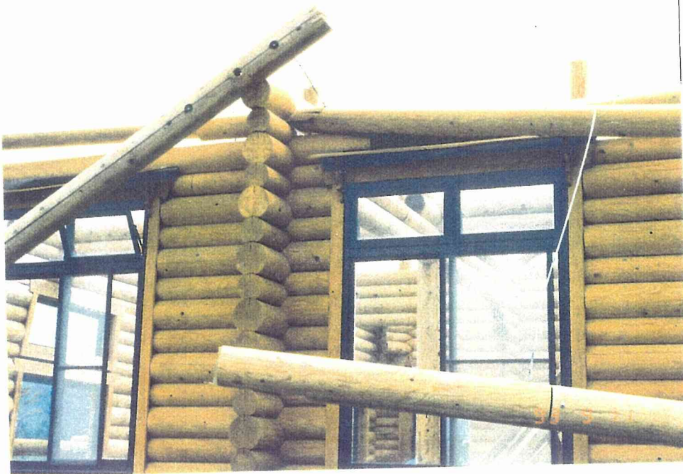
通しボルトの引き 抜きの状況
