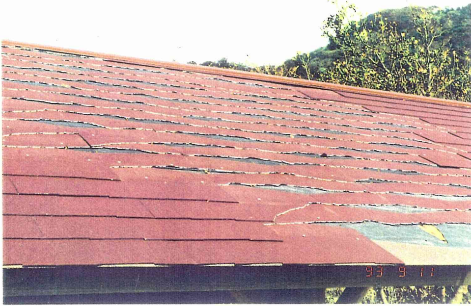
カラーベストが 折れた状況
