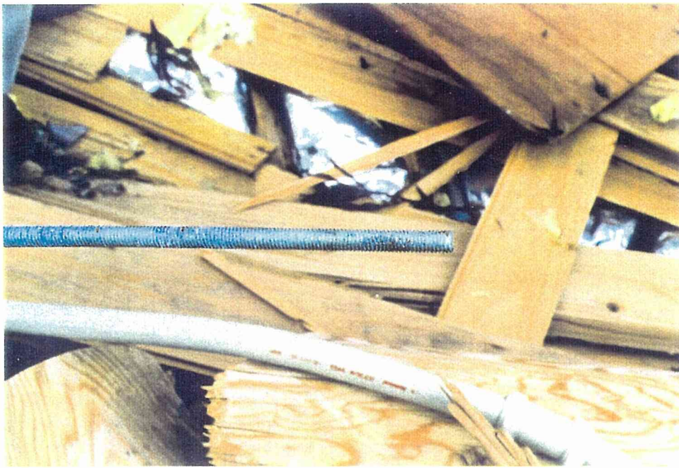
ボルトの引き抜け ネジ山はそのまま
