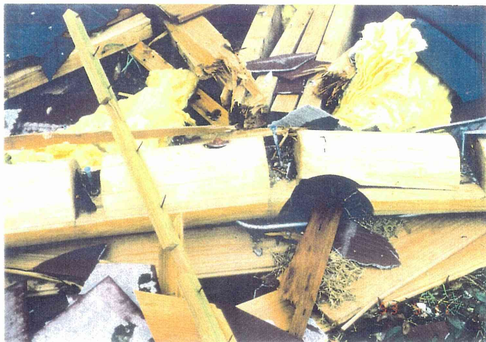
飛散した小屋組 ボルト引き抜け
