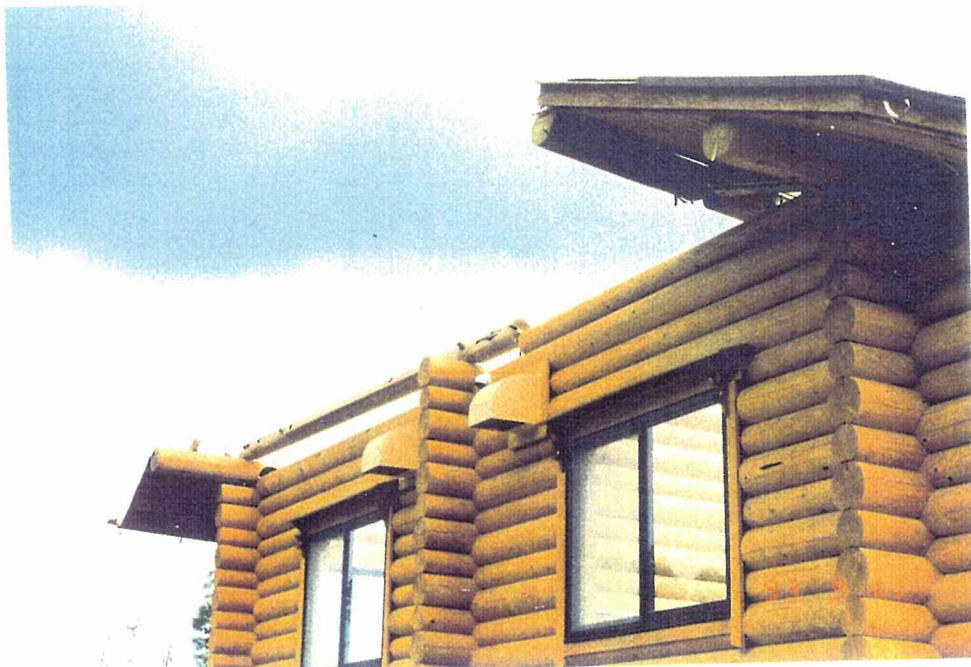
通しボルトの引き 抜きの状況
