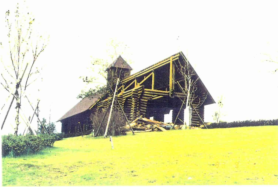
小屋組が飛散、左側ノッチに衝突折損
