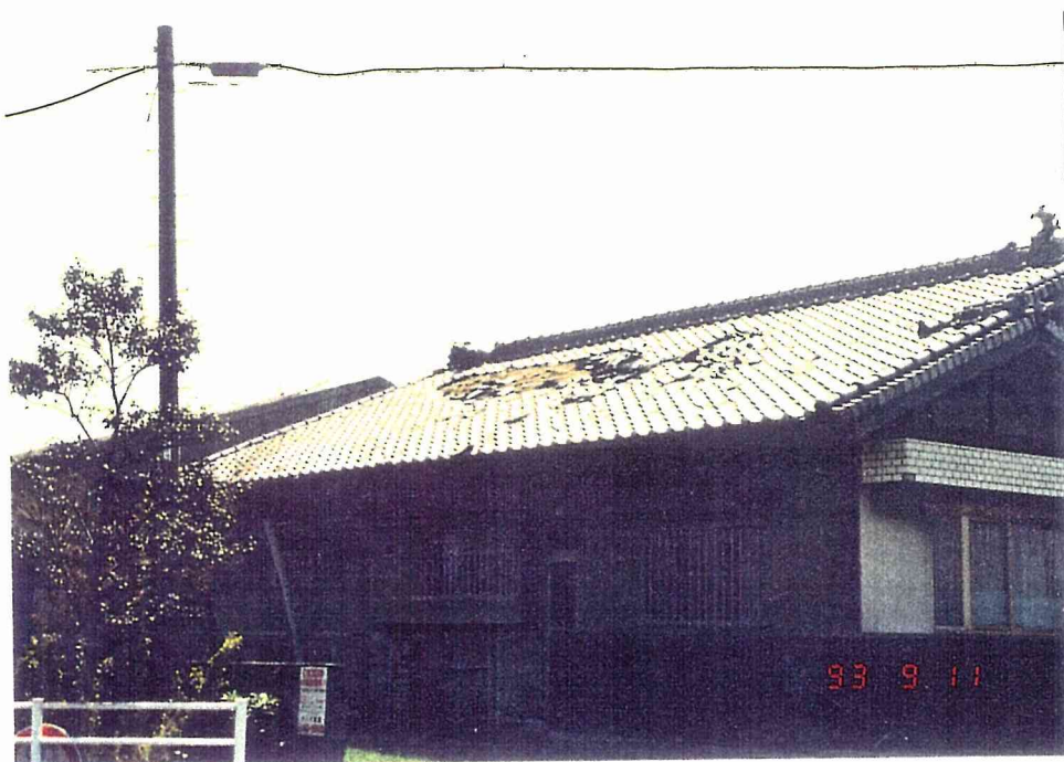
かわら屋根中央部の飛散、屋内からの吹上げか。
