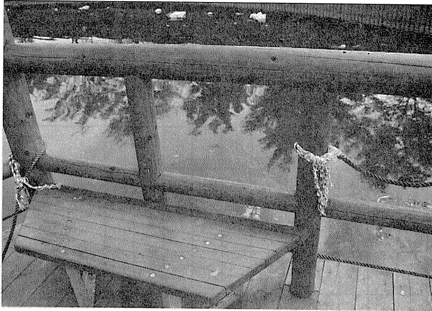
写真5 ベンチ部欄干のロープ破断
