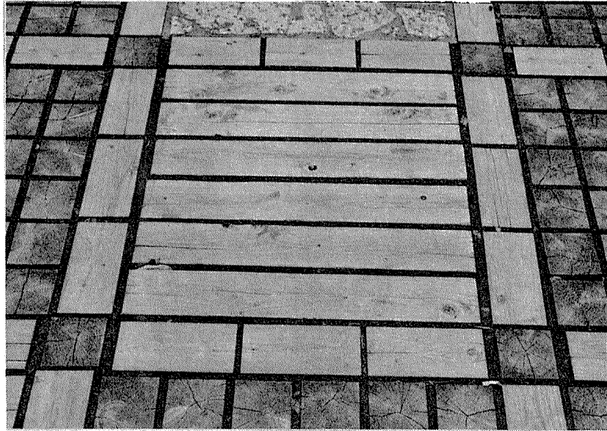
写真1 試作舗装の経過観察 1993.11.30 ウッディランド東京 木レンガ a (木口面), b (板目面 l=190), c (板目面 l=590) いずれも 干割れが目立ち、退色も著しい。cは、がたつくものが 少なくない。
