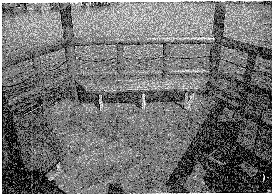
写真7 ベンチ座面およびデッキの塗装のはげ
