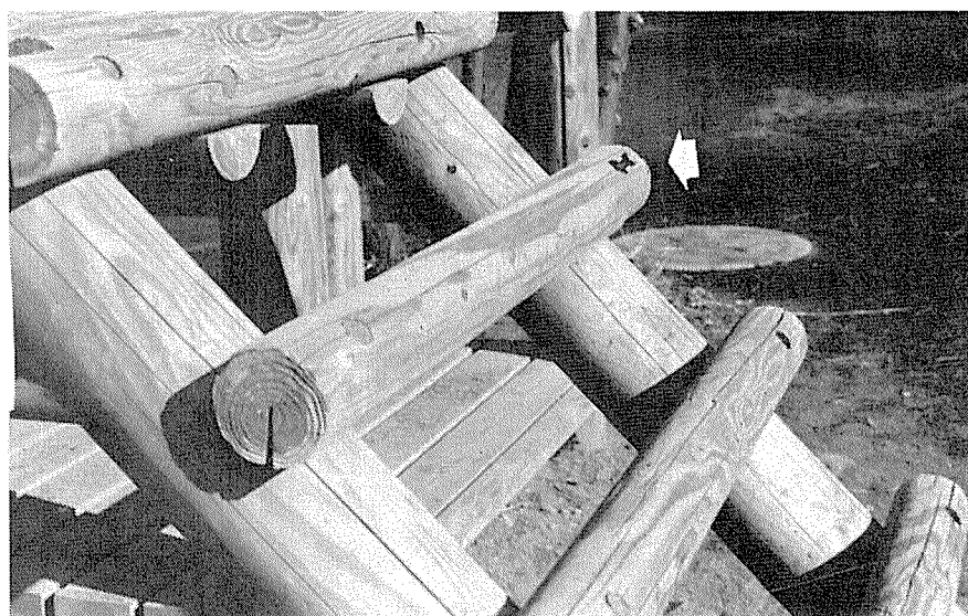
写真7 ナットの脱落した木製遊具の梯子
