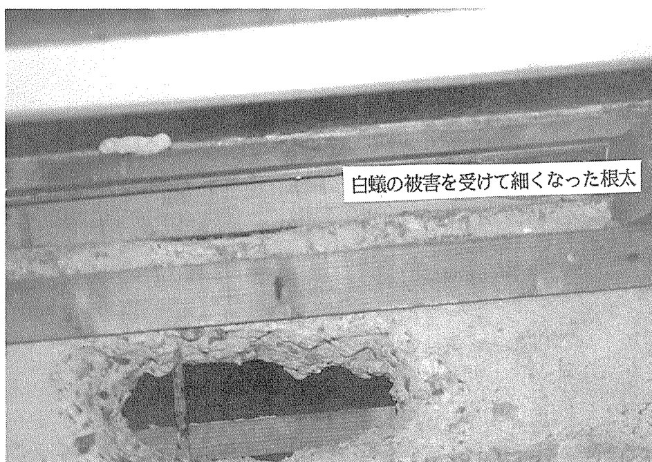
写真 5-2 白蟻の被害を受けた根太および通気のために穴を開けられたコンクリート基礎（事例3）
