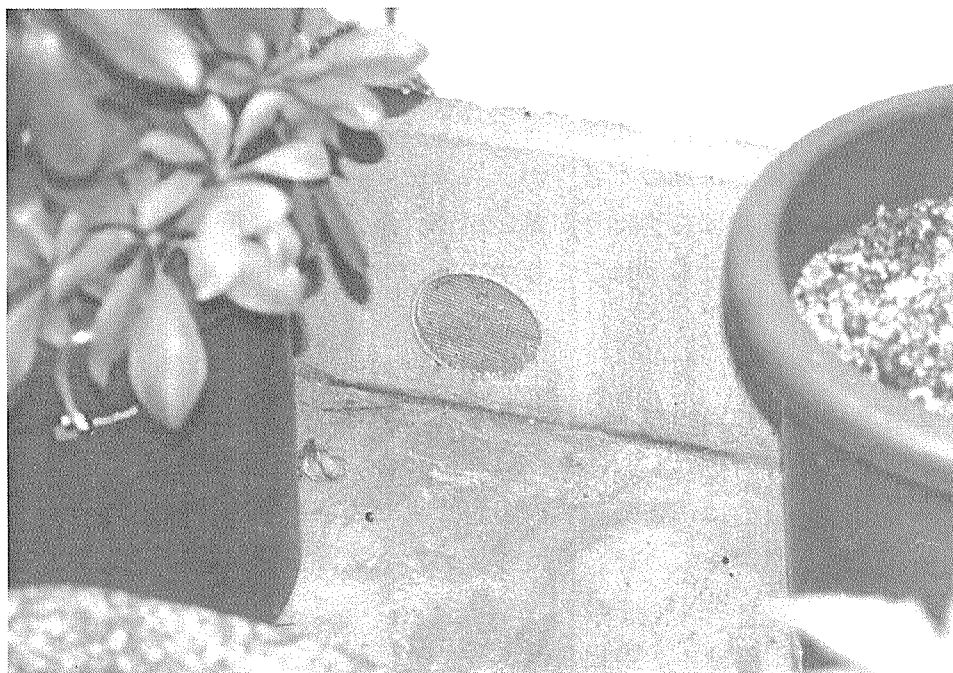
写真 5-1 小さな換気口（事例3）
