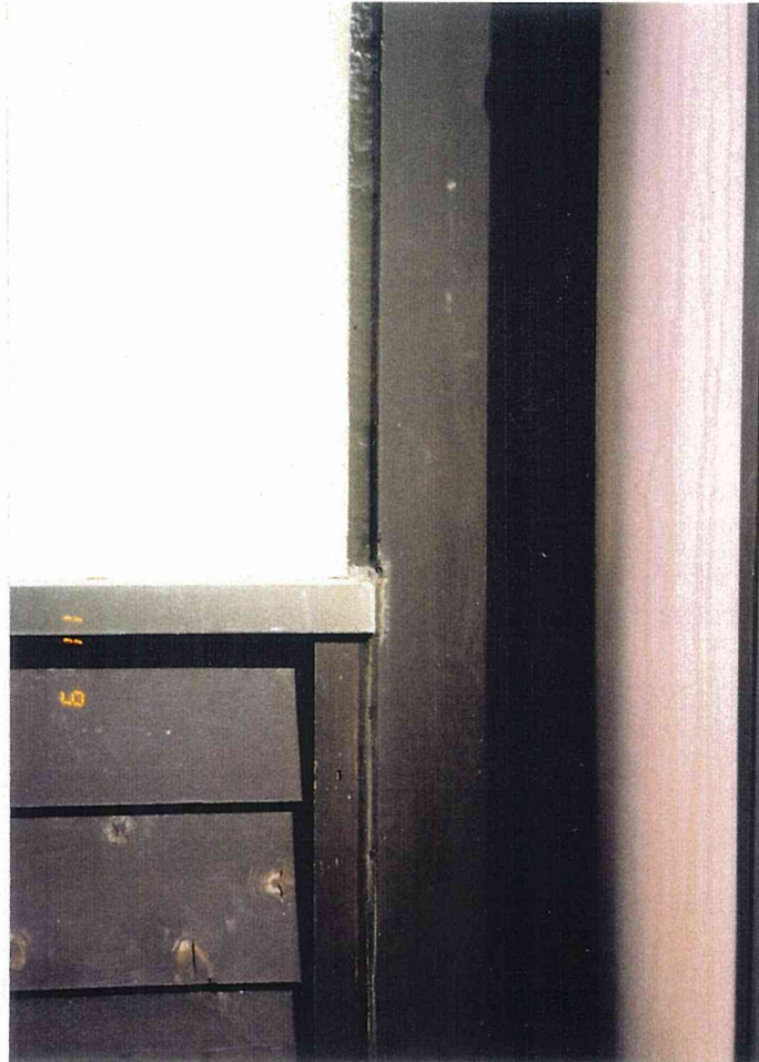
写真2-14 小学校校舎：外壁と玄関柱の隙間
