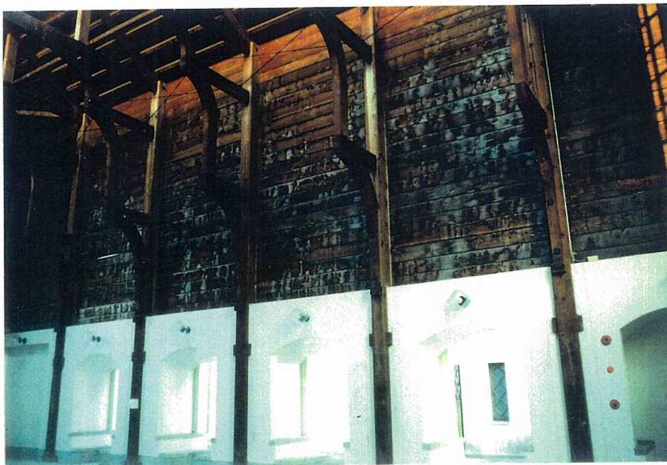
写真2-8 高等学校多目的ホール：壁面の汚れ
