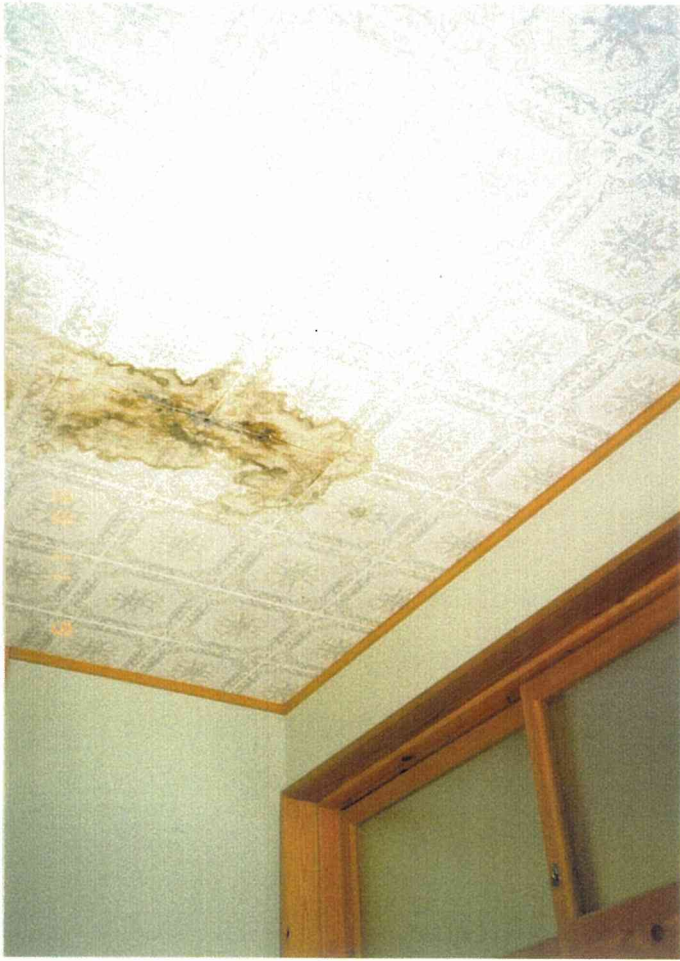
写真2-13 小学校校舎：教室天井の雨漏り跡
