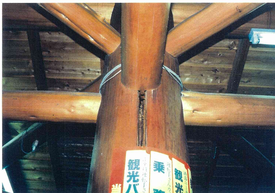
写真2-10 ドライブイン：丸柱の割れ（ホゾより大）
