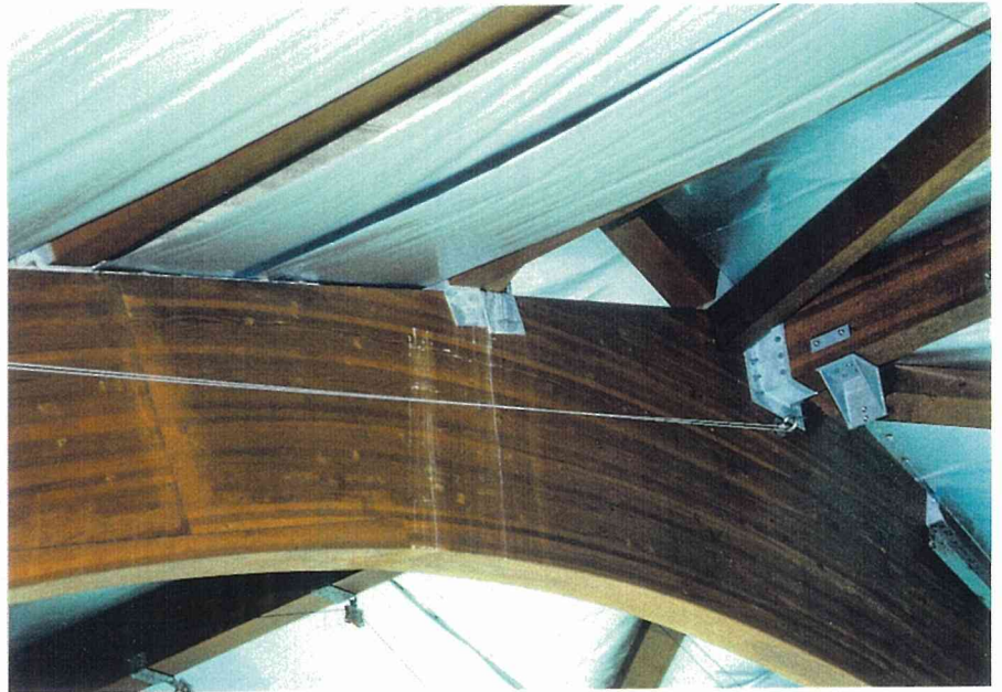
写真2-29 温水プール：天井金物の白亜化
