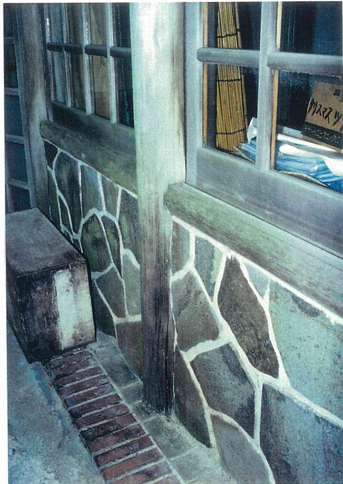
写真2-18 ドライブイン：外部に面した柱脚の腐朽
