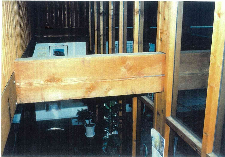
写真2-11 木の広場：梁の割れ（コーキング処理）
