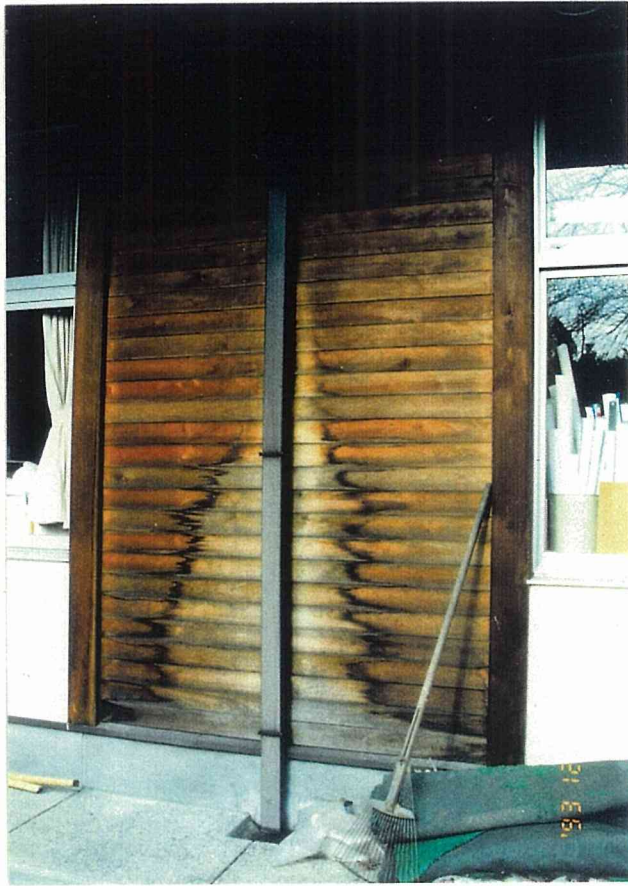
写真2-15 保健センター：下見板の汚れ
