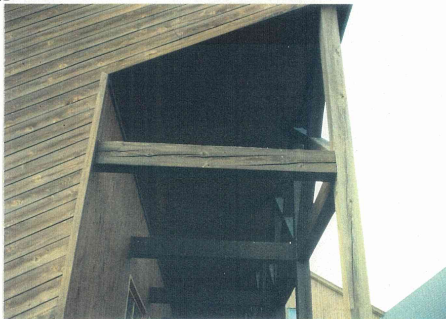
写真2-32 木材普及センター：軒干の部材の割れ
