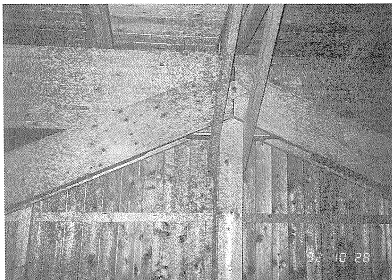
スイス、ウィミスの木造トラス橋のカラマツLVL斜材 (スカーフジョイント部分-左側が見える)
