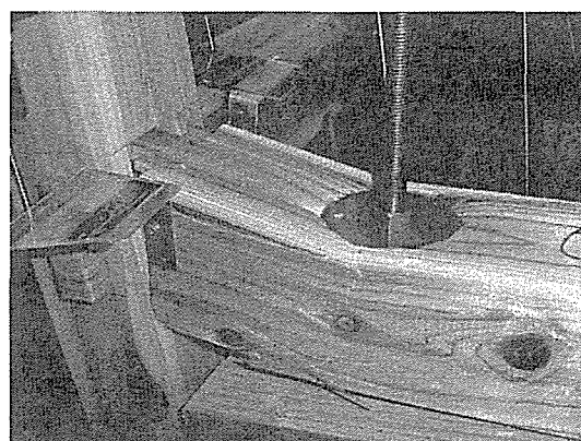
写真2-17 破壊状況 土台の曲げ破壊
