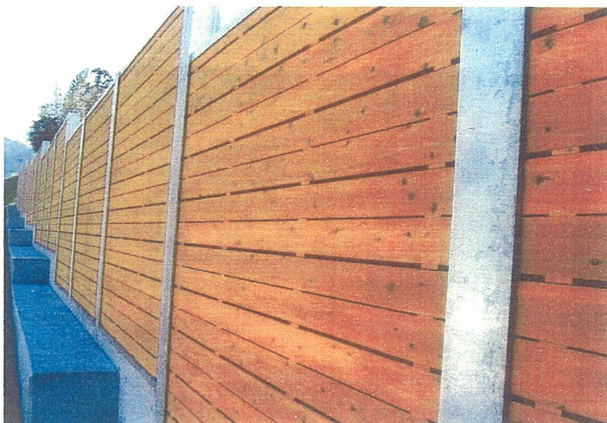
写真Ⅲ-4 設置遮音壁の前面（道路側）
