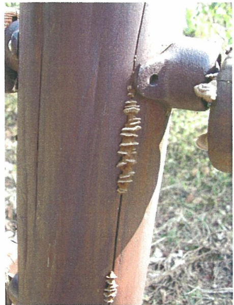
写真1-3 干割れ部分からの子実体の発生
