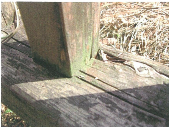
写真1-2 水はけの割部分の劣化
