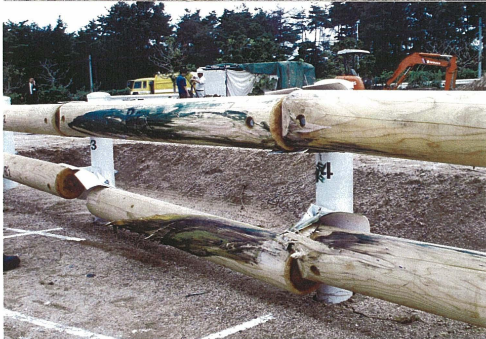
写真 2 - 6 衝突後の防護柵 (1)
