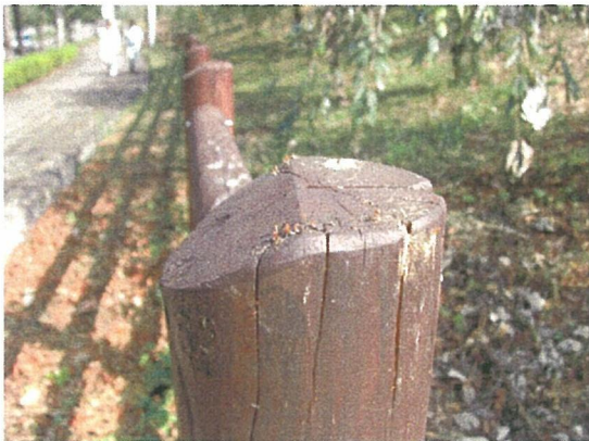
写真1-1 柱頂部の劣化
